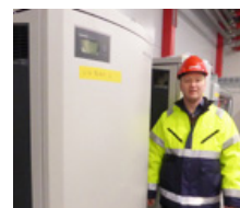
Stora växelriktare till en stor anläggning.
